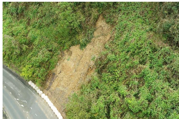
図-5 切土斜面崩壊(宮崎市)
