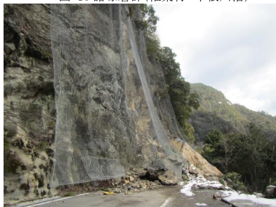
図-20 岩盤崩壊(椎葉村)
