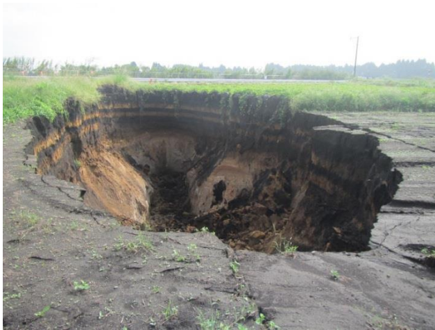
図-1 しらす地盤の陥没(都城市)
