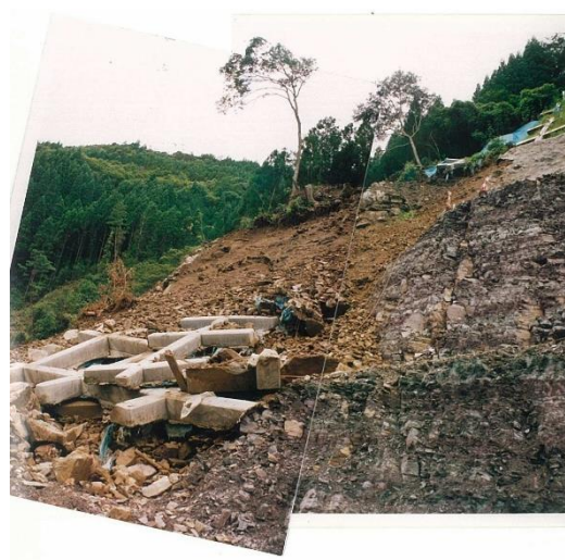
図-19 斜面崩壊(諸塚村 恵後の崎)
